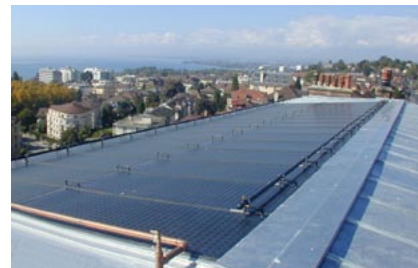
Sonnenkollektoren auf dem Hoteldach Quelle: Stadt Lausanne
