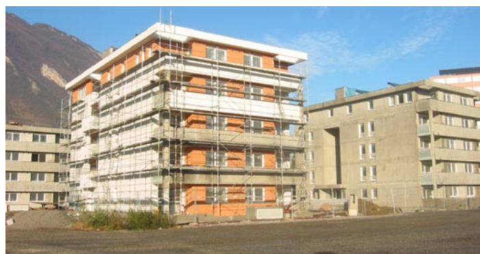
Sanierte Wohngebäude mit solarthermischer Anlage in Montmélian Quelle: CLER
